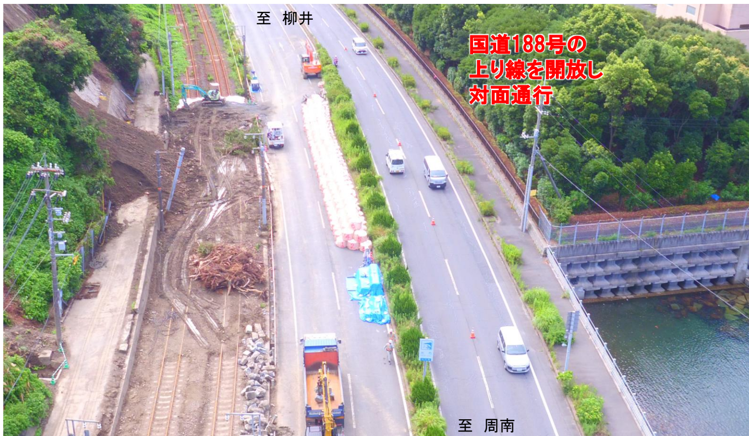
▲土砂災害の発生状況(下松市)
