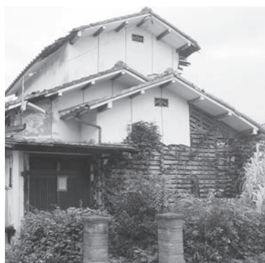
▲老朽化し外壁が剥がれた空き家
