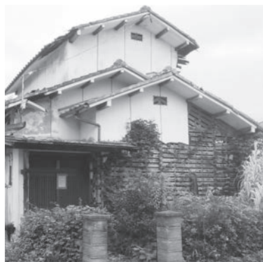
▲老朽化し外壁が剥がれた空き家
