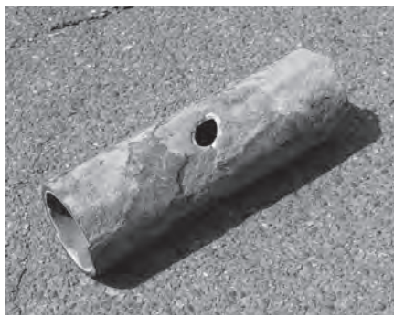
▲穴が開いた金属製の水道管。金属製でも老朽化すると穴が開き漏水します。
