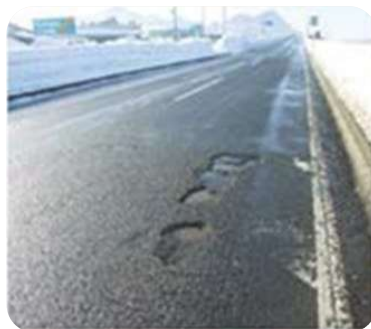
路面の穴ぼこ・ 段差
