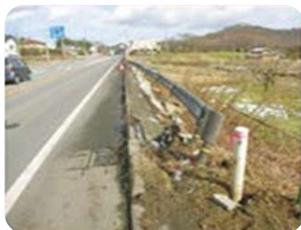
ガードレール・ 標識等の損傷
