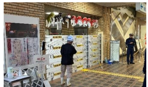
庁舎1階に設置した着脱式防水版
